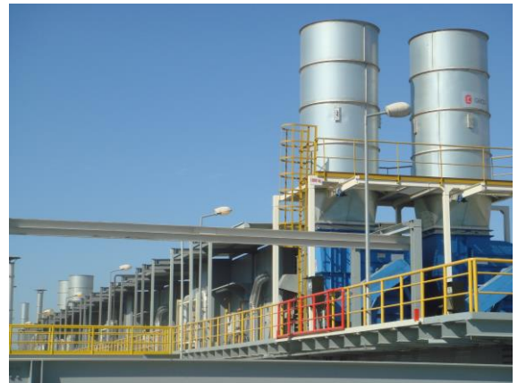
INCINERATEUR DE COV
